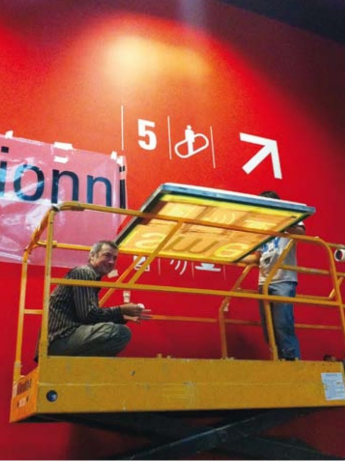
Téra-cr ation (ex-Th r se Troika), chantier pour la signal tique dans le cadre de la reconstruction du pavillon Amont, mus e d'Orsay, par l'Atelier de l' le, fabrication Boscher, 2011
